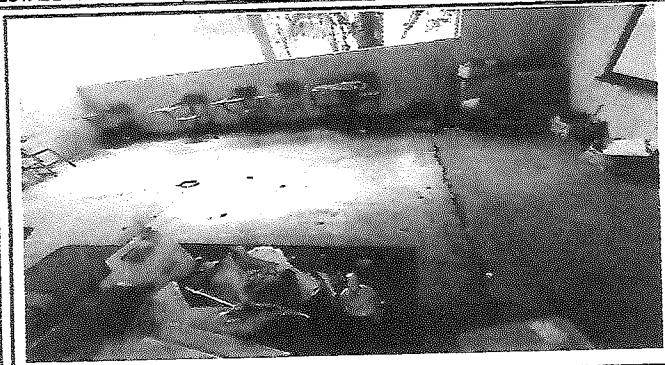
Foto 7: El piso de torta en un salón y corredor esta en mal estado.
